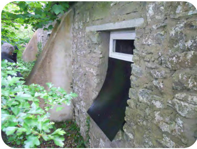
Fenêtre aménagée pour l'accès des Petits Rhinolophes, tout en évitant l'intrusion de carnivores, grâce à la plaque métallique sous-jacente.
