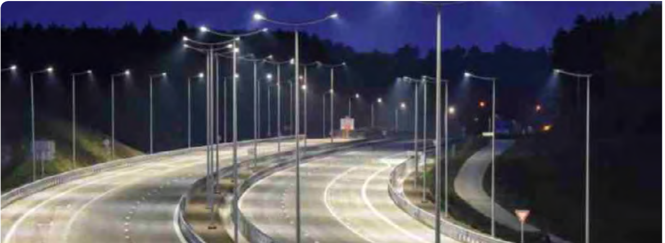
L'éclairage du réseau routier régional passe au LED. C'est l'occasion de le moduler pour restreindre son impact pour la faune
